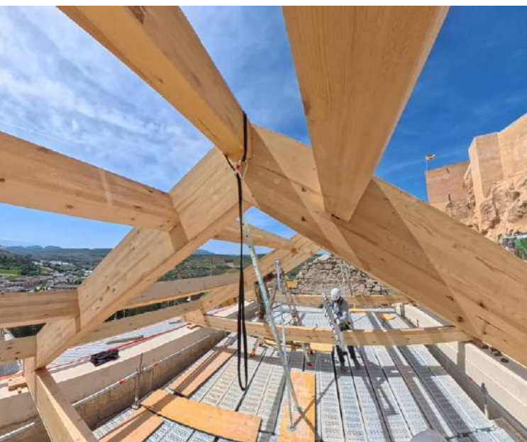
INSTALACIONES DE IBEROLAM
